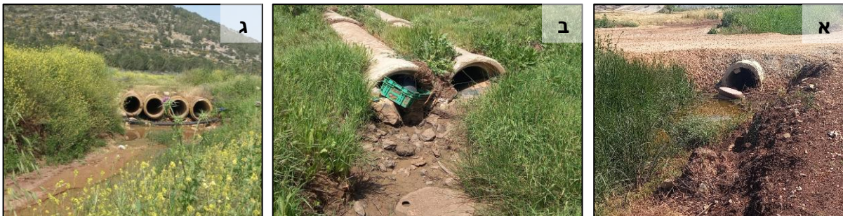
איור 2: מעבירי צינור. א. מעביר צינור צר מרוחב הערוץ, ב. מעביר צינור סתום חלקית, ג. מעביר צינור גבוה מתשתית הנחל.
